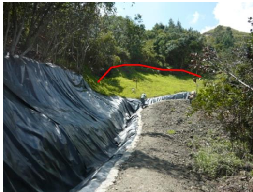
Gráfico No. 88Cuneta para reemplazar el canal central en la base de un deslizamiento antiguo.
